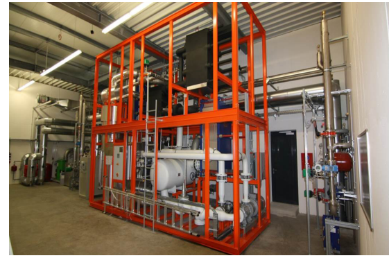
Abb. 3: NH 3 - Absorptionskälteanlage (Quelle: AGO AG Energie + Anlagen)
