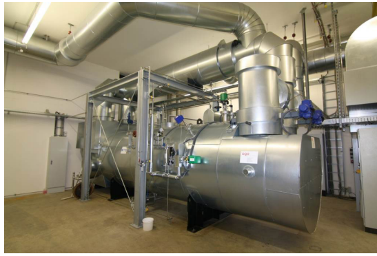
Abb. 2: Gemeinsamer Dampferzeuger für zwei Blockheizkraftwerke. (Quelle: AGO AG Energie + Anlagen)
