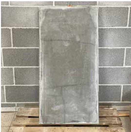
Abb. 57 Vorderseite / Außenschicht – In der Ober- fläche sind Rissbildungen zu erkennen (Ohm-AR)
