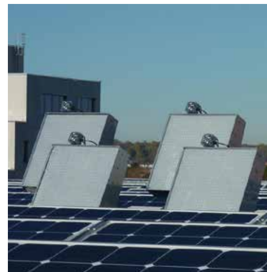
Abb. 3 Sollektor-Version LCA 251 (2013), Anordnung auf einem Flachdach
