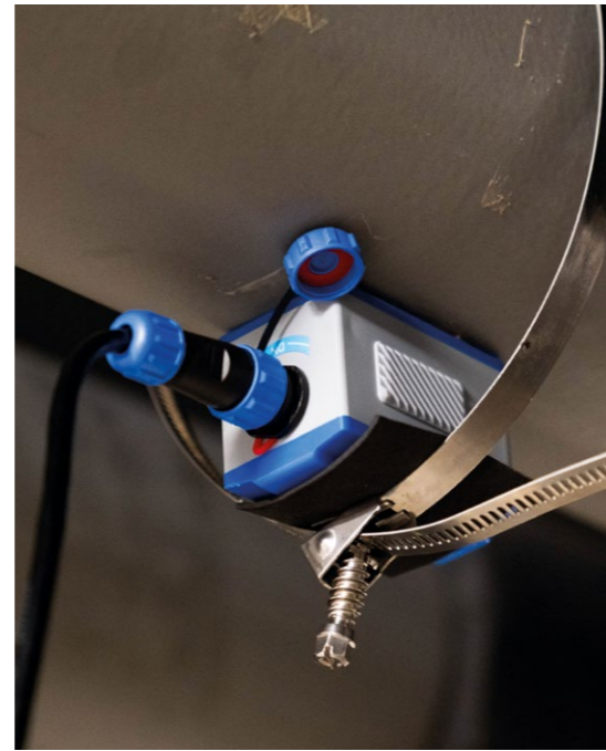
Dieser Zähler am freigelegten Rohr erfasst die Kältemenge, die zur Kühlung der Server ins Rechenzentrum fließt.
