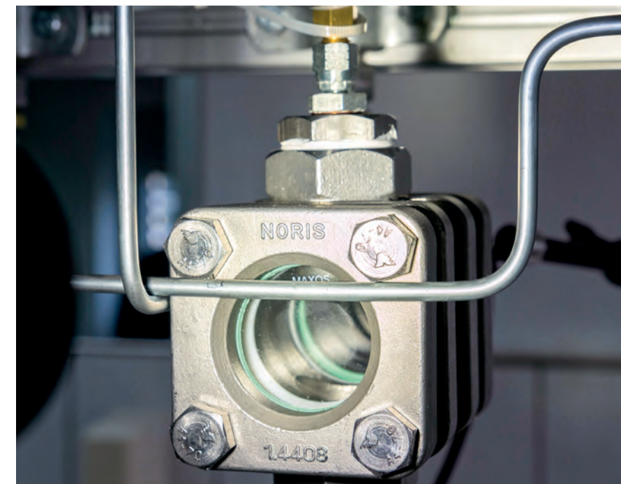
Ein Schauglas mit Hochgeschwindigkeitskamera und LED am Verdampferaustritt hilft bei der Detektion von Kältemitteltropfen.
