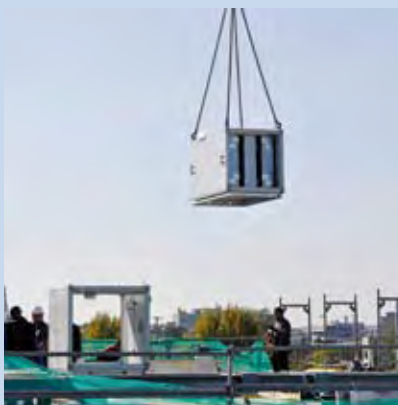
Der Austausch von Lüftungsanlagen – hier auf dem Dach des B-Baus am Keßlerplatz – gehört zu den lange fälligen Sanierungsmaßnahmen.
