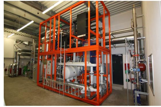
Abb. 3: NH 3 - Absorptionskälteanlage (Quelle: AGO AG Energie + Anlagen)
