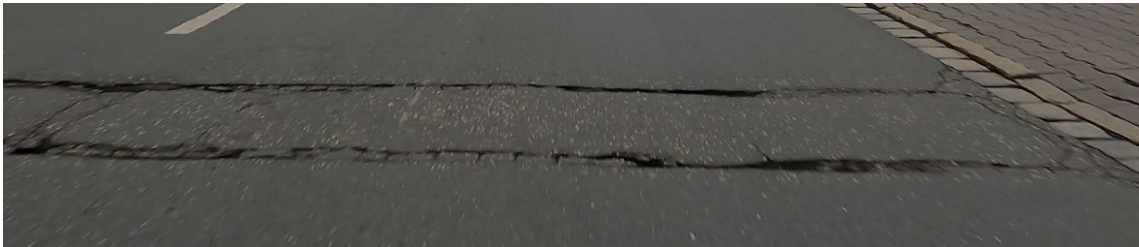
Abbildung 21: Straßenschaden bei maximalem Ausschlag der Beschleunigung
