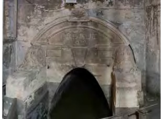
Zulauf südlicher Hauptsammler
