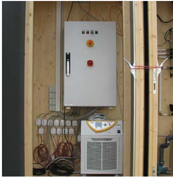
Abb. A5 Schaltschrank, Messumformer Kryostat (THN-AR)
