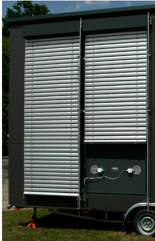
Abb. A28 Rednitzhembach, Technikum/ Fassadenversuchsstand – Referenzraum mit Verglasung und Raffstore (THN-ieg)
