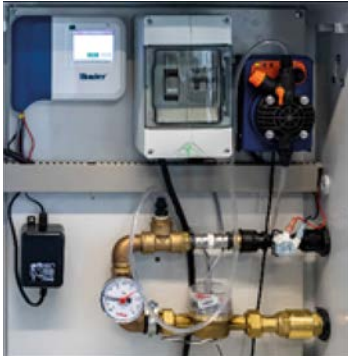
Abb. 83 Schaltschrank zur Bewässerungssteuerung (IBP)
