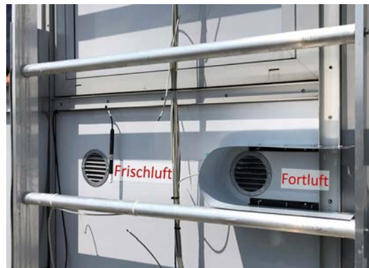
Abb. 77 Frischluft- und Fortluftöffnung am Testraum mit Abschottungen in 2021 (IBP)
