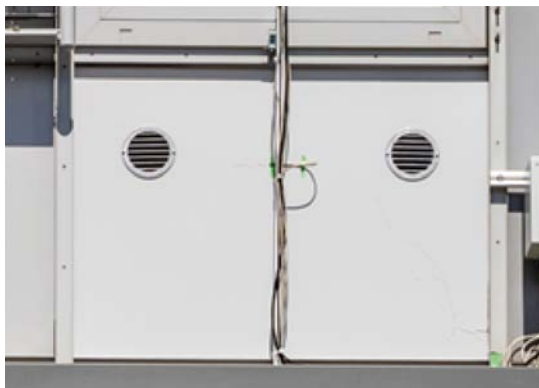
Abb. 76 Frischluft- und Fortluftöffnung mit Insektenschutzgitter (IBP)
