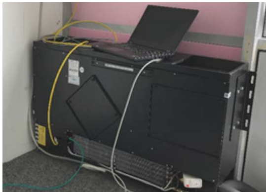
Abb. 74 Innenansicht des DFL-Gerätes während der Inbetriebnahme (IBP)
