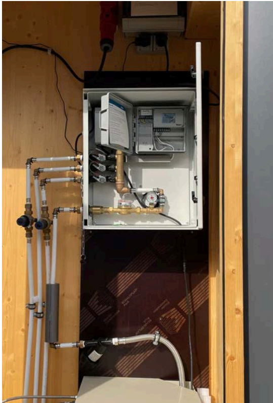
Abb. A18 Rednitzhembach, Technikum/ Fassadenversuchsstand – Bewässerungsanlage (THN-AR)
