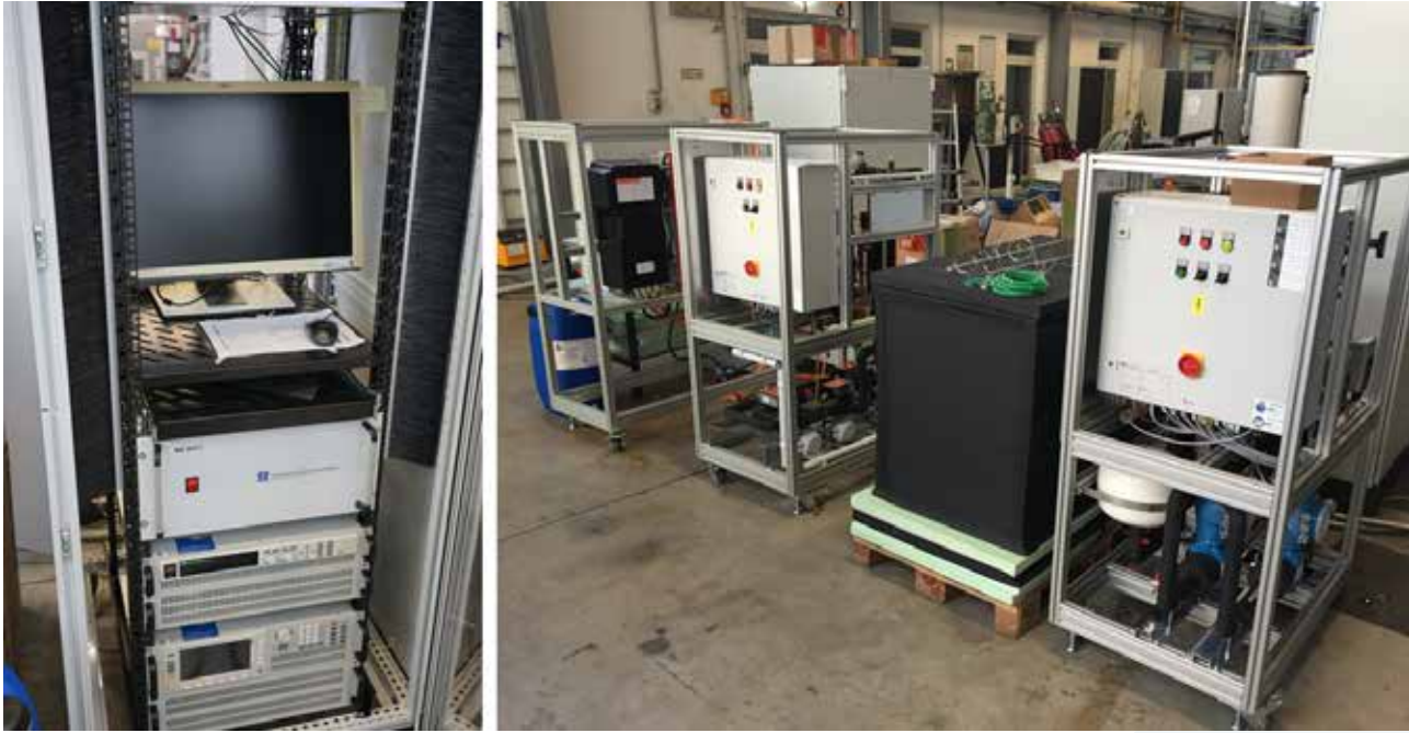
Abbildung 2: Aufbau der Versuchsanlage (Messdatenerfassung und Steuerung, simulierte PV-Quelle und elektronische Last, Batterie und Wechselrichter, Kälteanlage, Eisspeicher, Hydraulikmodul v.l.n.r.). Foto: Tim Neiertz
