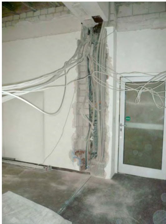
Abbildung 20: Kabelgewirr im Eingangsbereich
