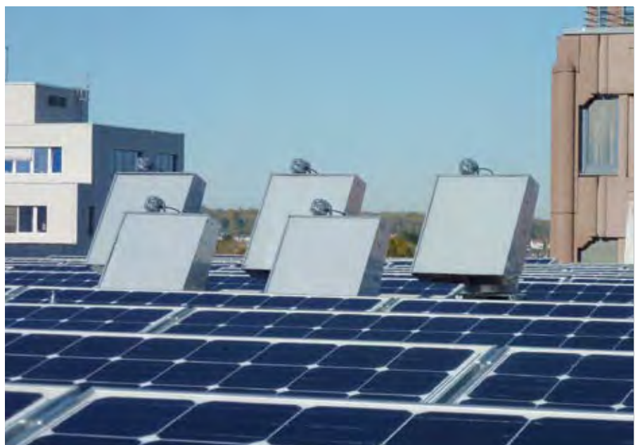
Forschungsprojekt BIOSOL: Sollektoren folgen dem Lauf der Sonne wie bei dieser Anlage der Firma Ed. Züblin AG.
