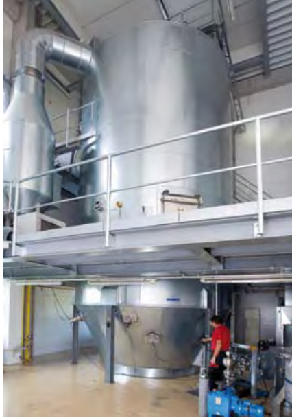
Sprühturm der Firma Dorst Technologies.
